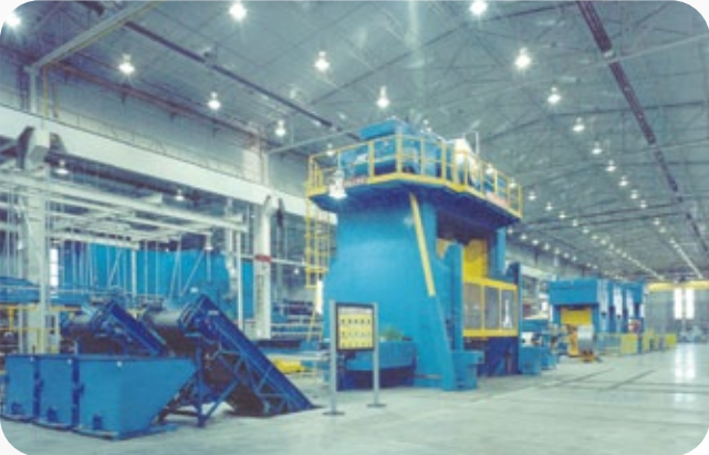
Fabrika Uygulaması: Seri Yakıclı Sistem - Genel Isıtma
