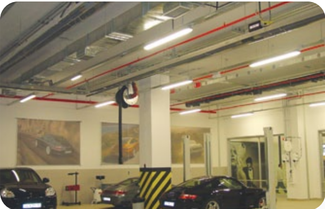
Oto Servis Uygulaması: Seri Yakıclı Sistem - Genel Isıtma
