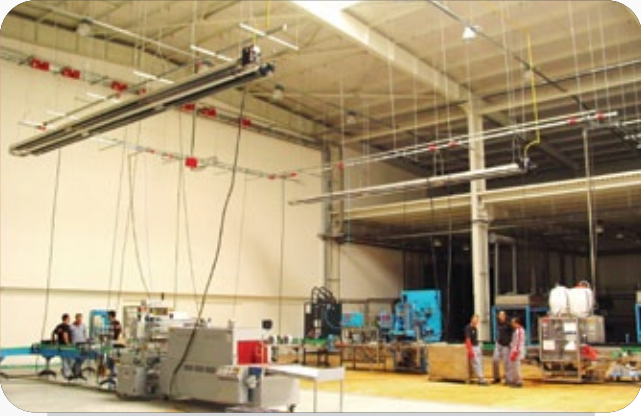
Fabrika Uygulaması: U Tip Üniter Sistem – Lokal Isıtma
